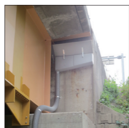
橋梁 簡易排水装置
