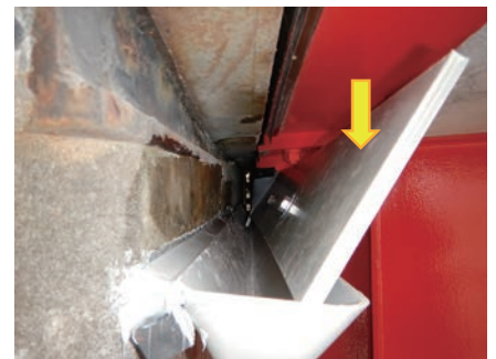
導水パネルにより伝い水も集水します
