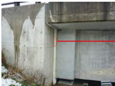
設置前 遊間内に発泡スチロールあり
