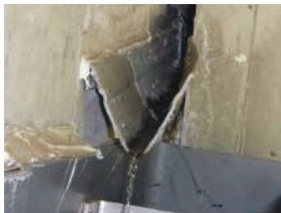
排水樋が伸縮装置の漏水を集排水しています
