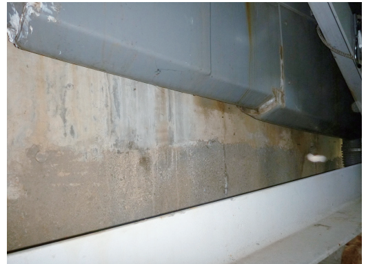
7年半経過しても装置より下部の壁面には汚れがないことから、製品の集水性能が維持されていることが確認できました。
