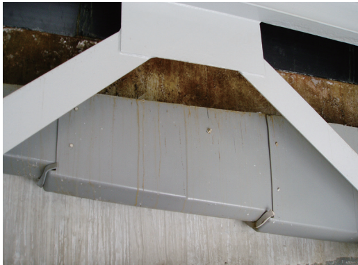
トータク簡易排水装置より上部は伸縮装置の錆による汚れが付着していますが、装置より下部は、装置が集水しているので、壁面に汚れがありません。
