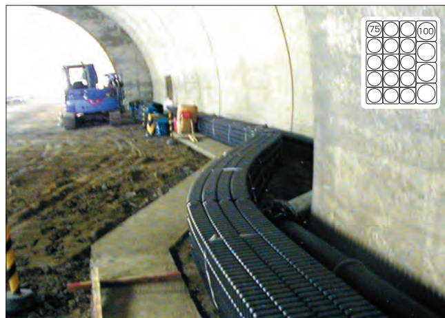
●トンネル内多条配管
