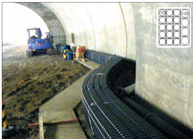
● トンネル内多条配管
